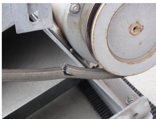
4) ベルトの破損
