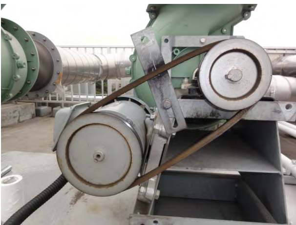
2) ベルトの破損、張りのゆるみ
